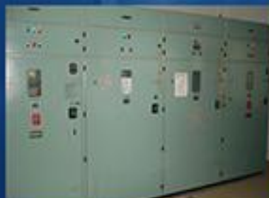
22KV, HT RMU Panel.
